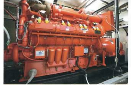
ガスエンジン発電機
