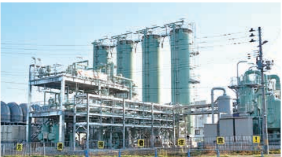
▶11月に操業した長岡炭酸(株)の製造プラント(越路地域・朝日)
