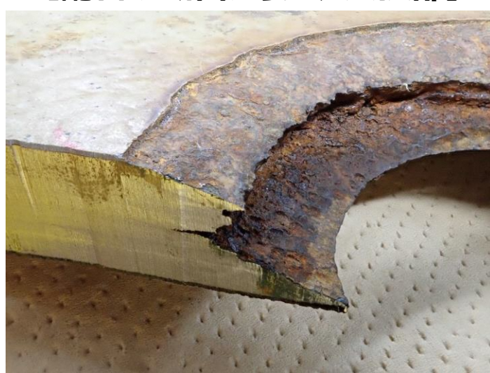
【配管切断面から見た欠損部】
