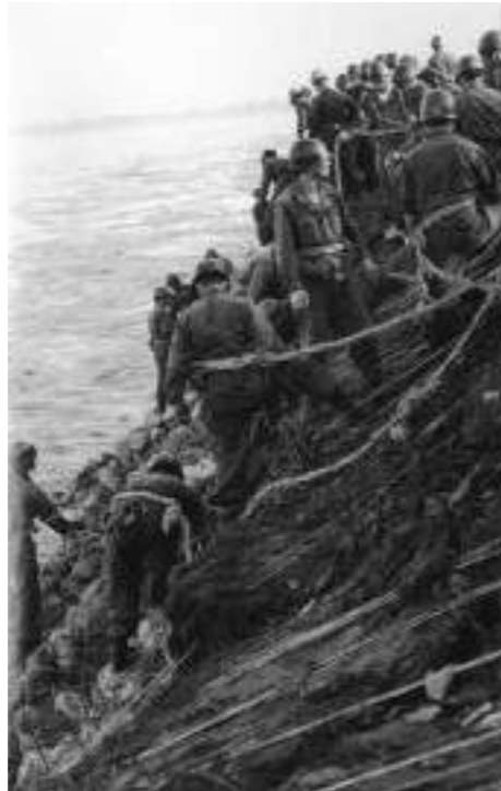
▲水梨町地内の信濃川堤防損壊(6月)
