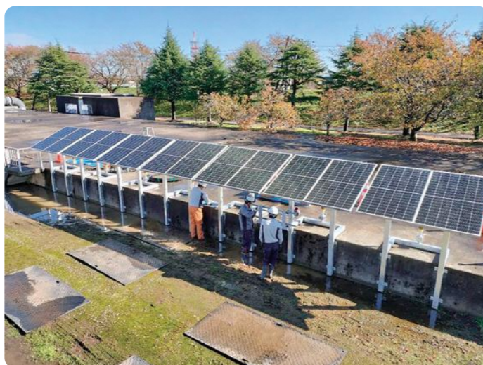
中央浄化センターにおける太陽光パネル
