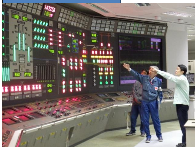
6号機中央制御室
