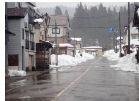
消融雪対策（消雪パイプ）
