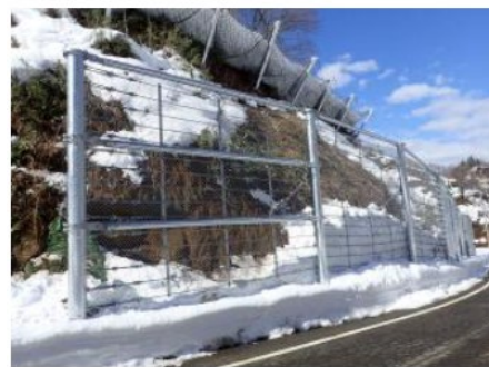
法面对策（防雪施設）
