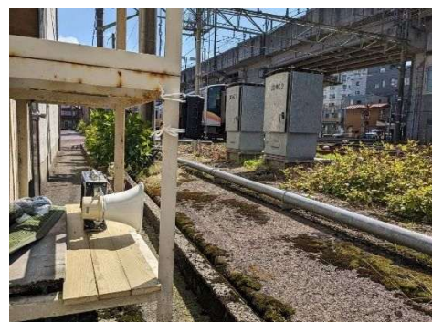
忌避音再生機器による追い払い
