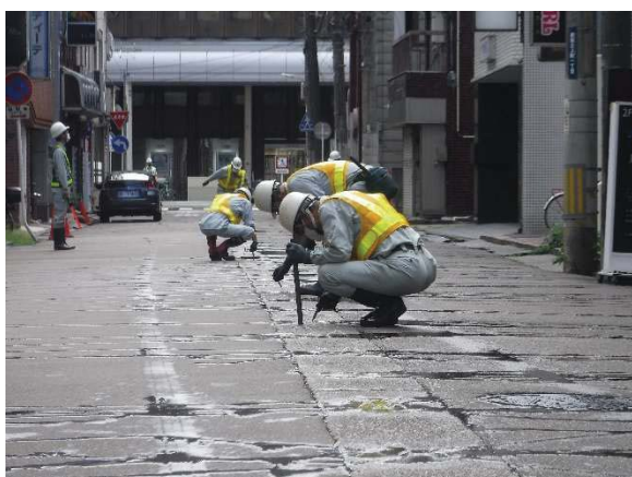
消雪パイプ点検
