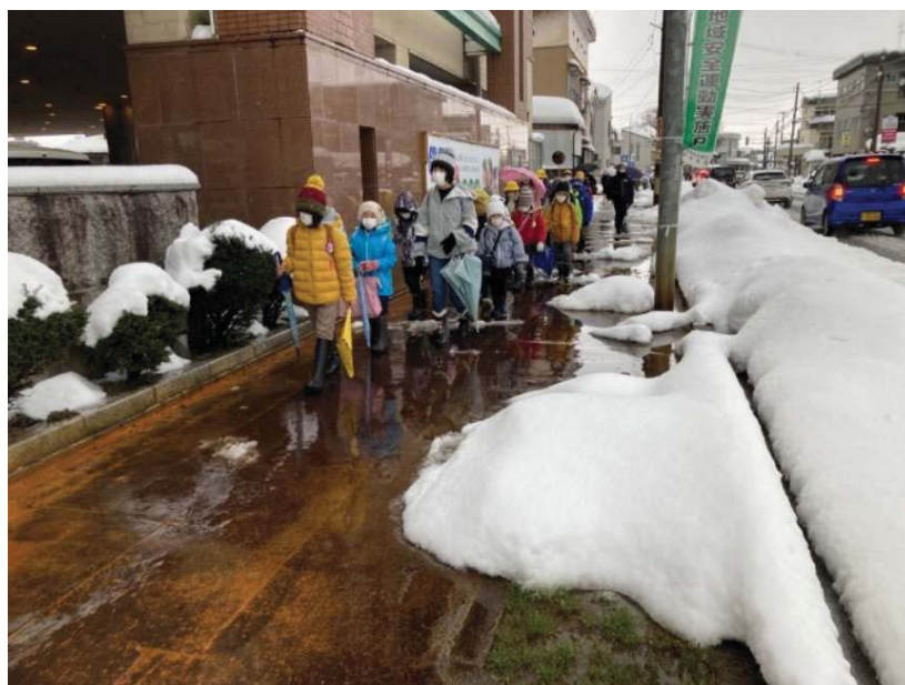
通学路歩道消雪パイプ
