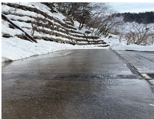
路面流水道路
