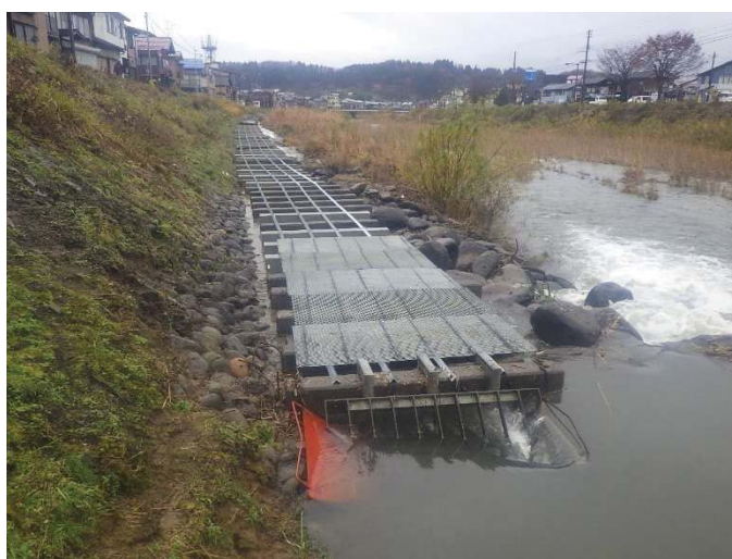
金町江流雪溝取水口（栃尾地区）
