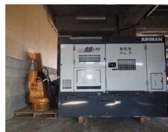
可搬式ポンプ・発電機の常備
