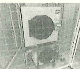
燕市の学校体育館に設置されている移動型エアコン
