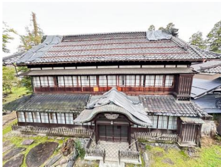
2-03 離れ座敷 東側外観 玄関破風と主屋根に破損あり
