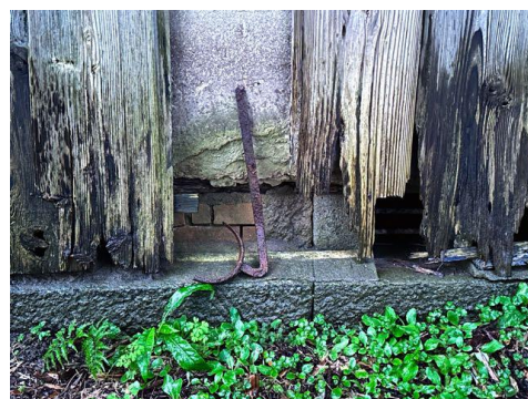
6-06 道具蔵 西側外観 外壁下部の腐朽
