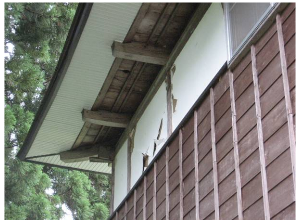
小国芸術村会館 外壁剥離
