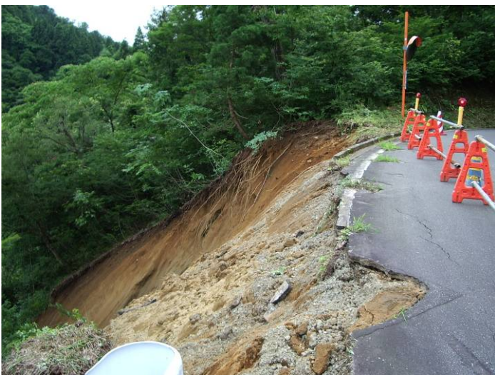
県道田代小国線 崩落
