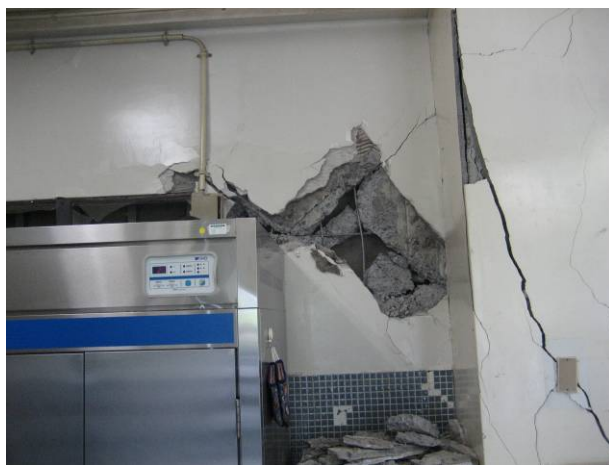
給食室の壁が崩落
