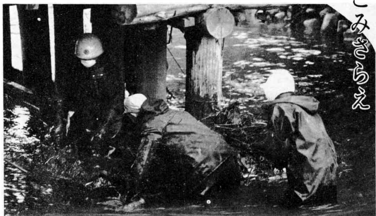
腰まで水につかり、橋脚にひっかかっているごみの取り除き……柳原地内で！
