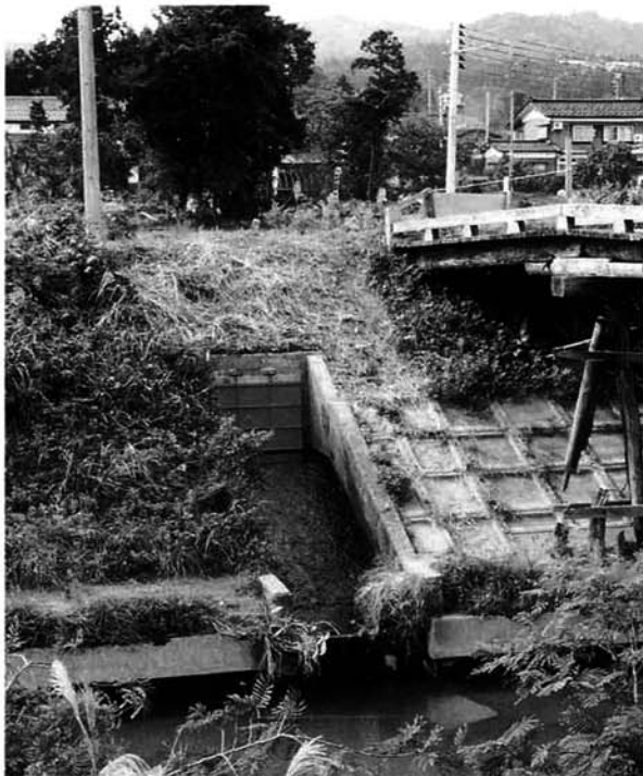
黒川（鳥越：松橋付近）に取り付けられた逆流防止弁
