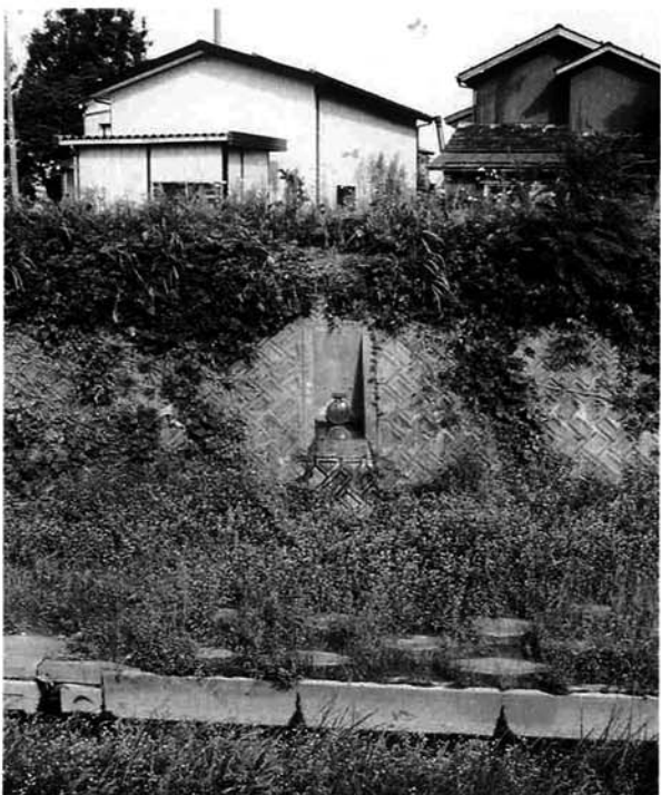
小木城川に設置された逆流防止弁
