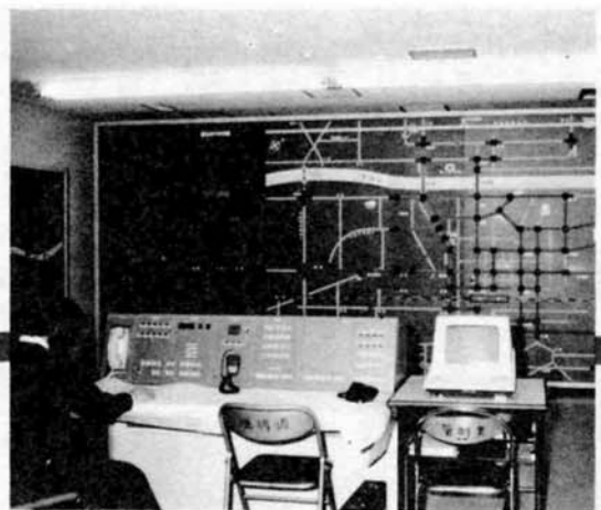
★交通管制センター
